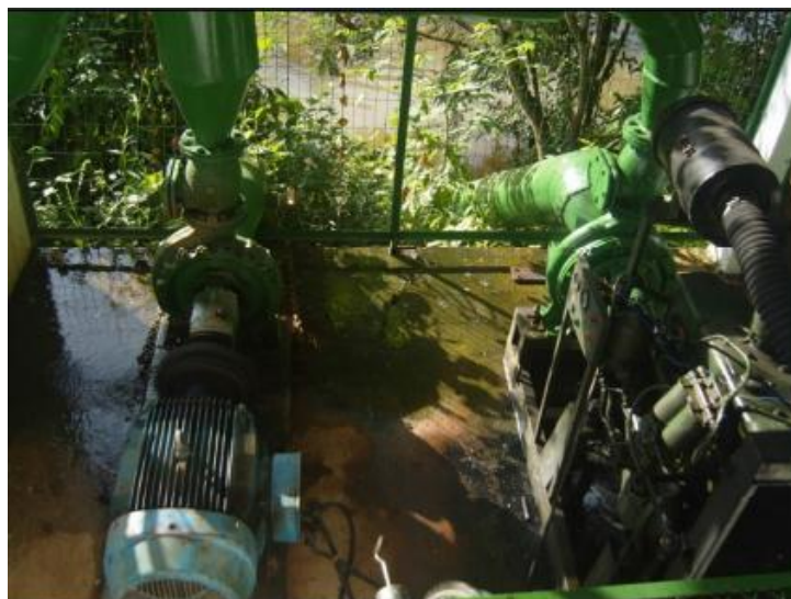
Figura 56. EEAB Motores Bombas.
