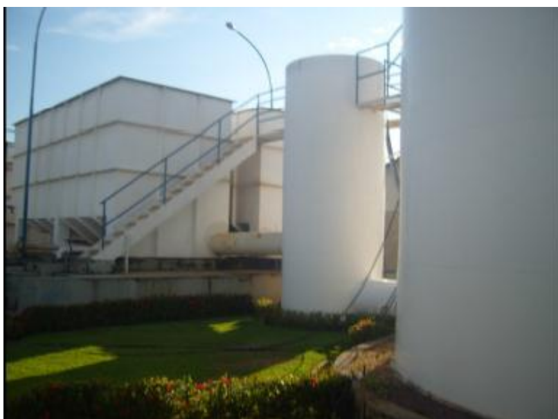
Figura 61. Vista Geral - Estação de Tratamento de Água – 50 L/s.
