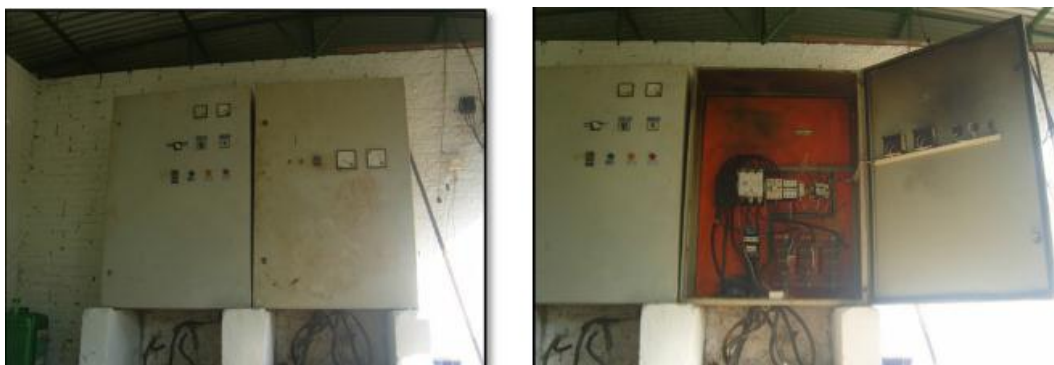
Figura 57. Quadro de Comando da EEAB.
