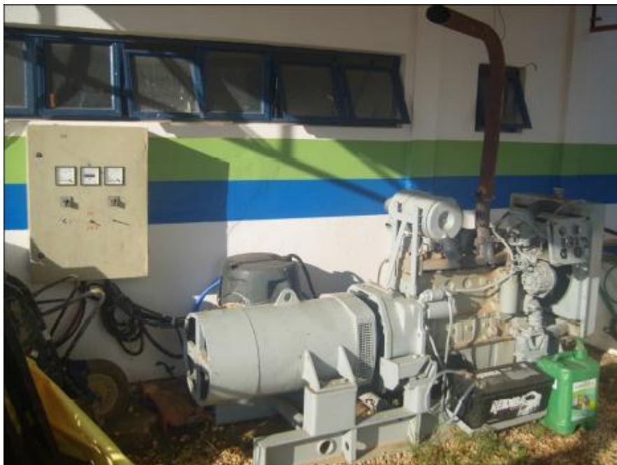
Figura 67. Gerador de Energia – EEAT.
