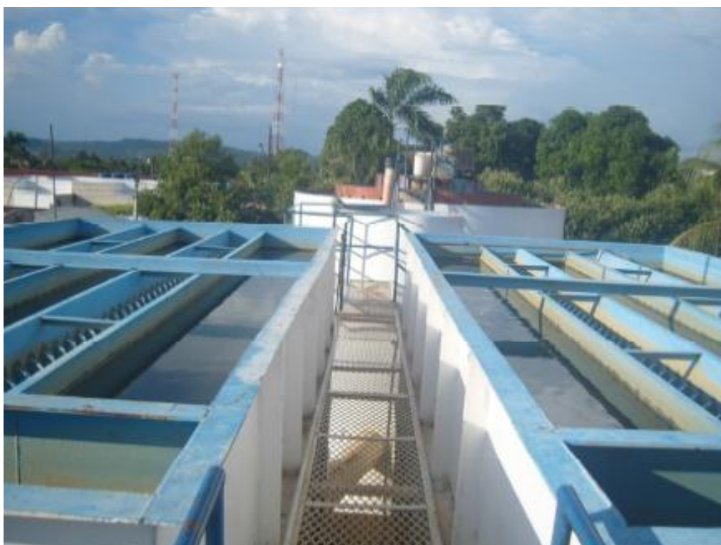
Figura 63. Decantador da ETA de Guarantã do Norte.
