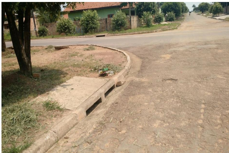
Figura 120. Boca de Lobo dupla de guia (sem proteção).
