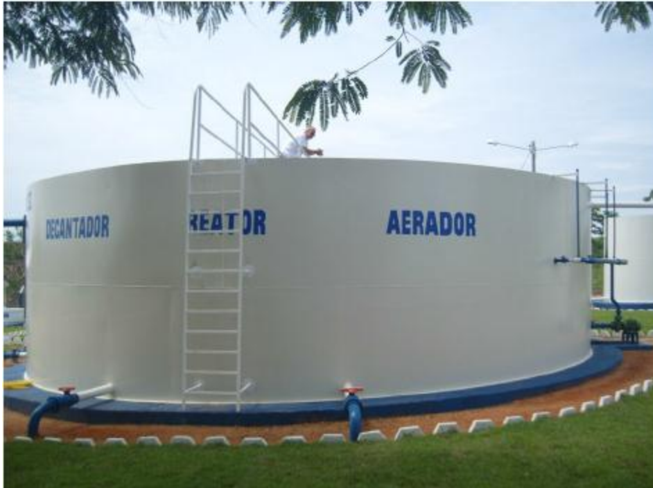
Figura 80. Aerador – Reator – Decantador.
