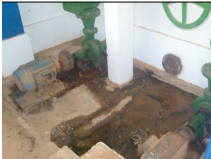
Figura 66. Disposição das bombas – EEAT 01.
