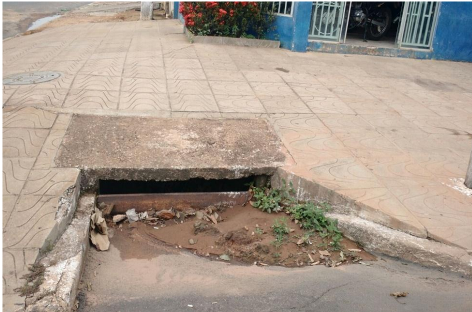
Figura 119. Boca de lobo simples de guia no centro da cidade.
