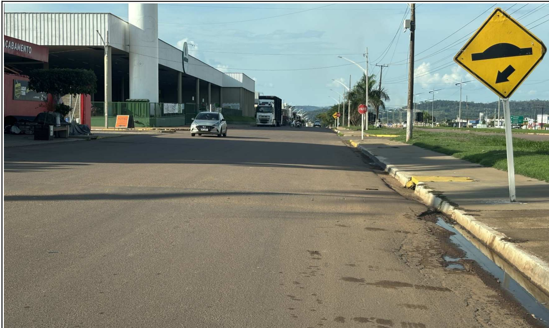
Foto 61: 09/11/2025. Lombada ausente de pintura amarela ou zebraada. Av. Pioneiro José Néilson Coutinho (Ref.: Hotel Sedna).
