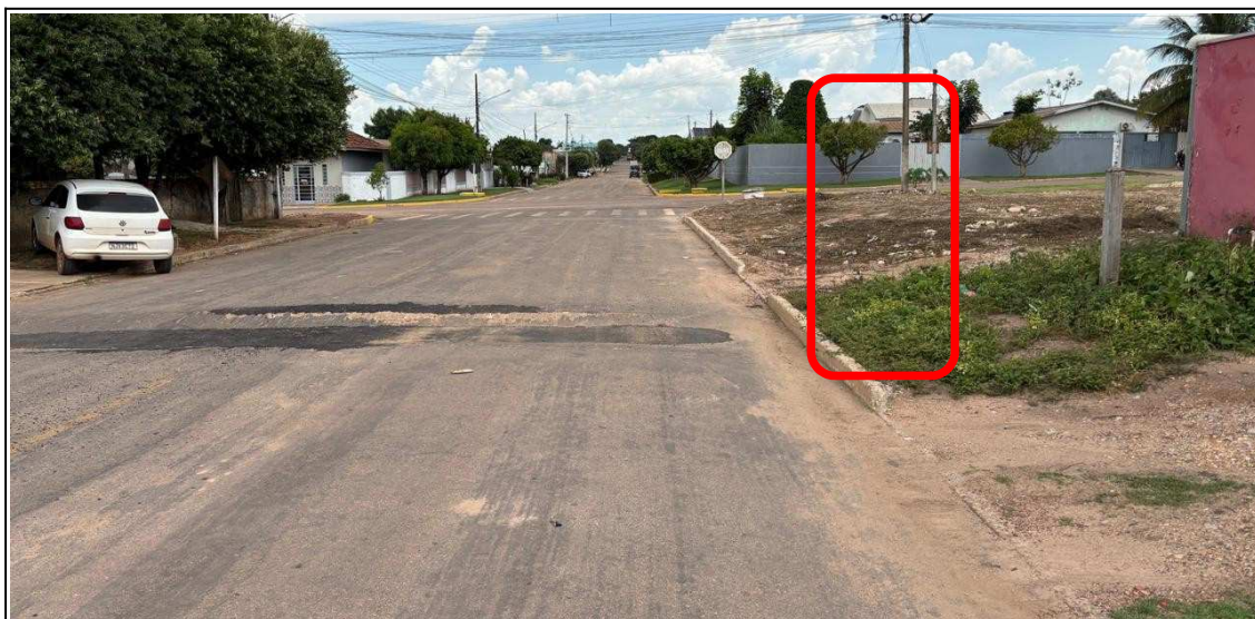
Foto 26: Realizada dia 06/11/2025. Depressão na Av. Magnólias, ausente de sinalização vertical A-19.
