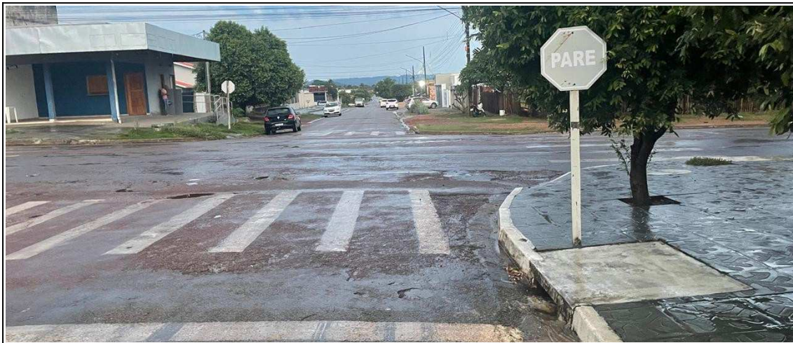
Foto 50: Sinal R1 em condição degradante. 29/10/2025. Interseção da Av. Magnólias com R. Cedros, centro.
