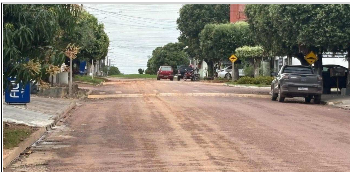
Foto 56: 07/11/2025. Presença de duas ondulações transversais (lombadas) seguidas (distância muito curta uma da outra). Rua dos Cajueiros (Ref.: Bar do Afonso).
