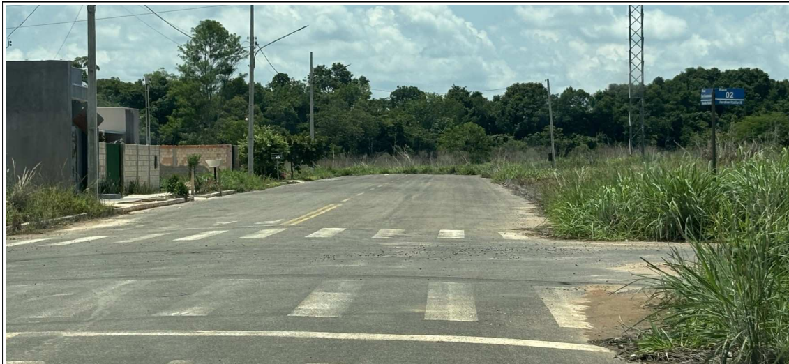
Foto: 29. 13/11/2025. Av. Castanheira – B. Jardim Itália. Vias com características de cul-de-sac (ruas sem continuidade de fluxo), ausente de sinal A-45.
