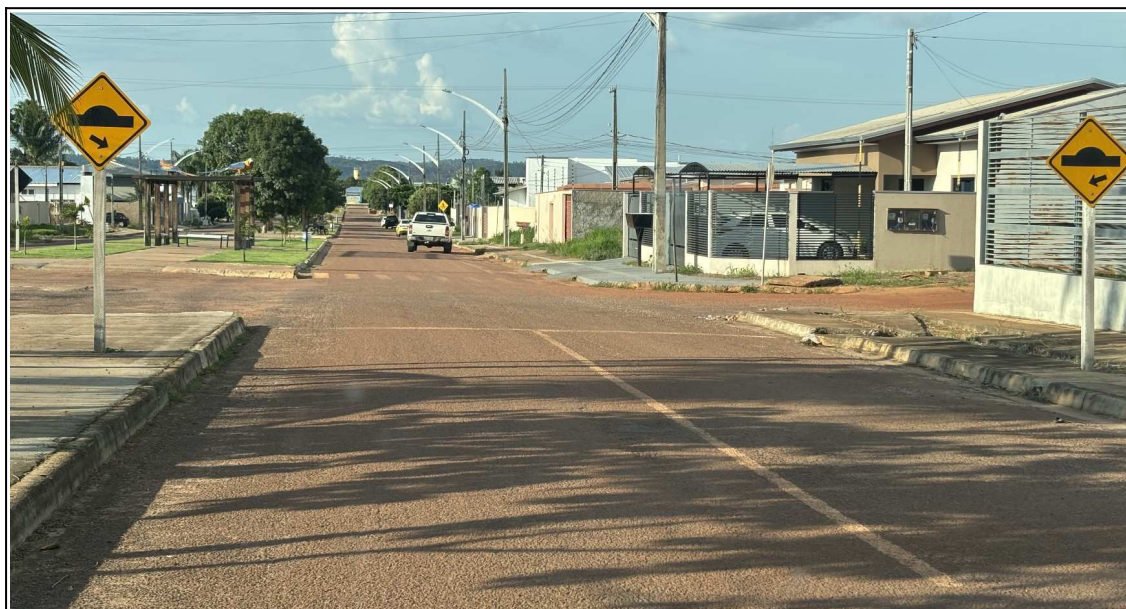
Foto 63: 09/11/2025. Ausência de obra da lombada, com a presença de sinal vertical. Fato faz com que o usuário perca a credibilidade de sinalização. Av. Mato Grosso.
