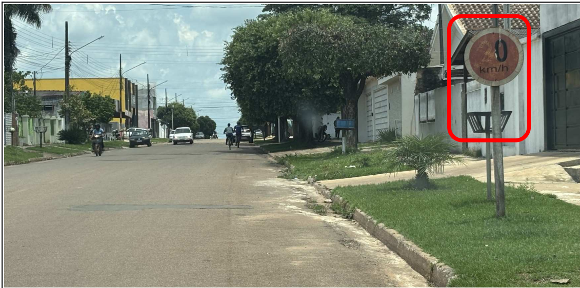
Foto 18: 13/11/2025. Av. das Castanheiras (Próximo a Bicletaria Catarinense). Observar que o único sinal R-19 (velocidade máxima) encontrado na Avenida estava em condições degradantes.
